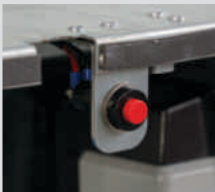
Türkontaktschalter aktiviert das Weidezaungerät. Zaun, Gehäuse und Solarmodul stehen unter Strom.
